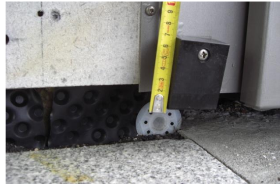
Mynd 20 Tæring (flögnuð málnig) við skrúfu í undirlista áklæðningar á suðurhlið.
