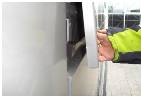
Mynd 14 Laus klæðning við SA-horn.
