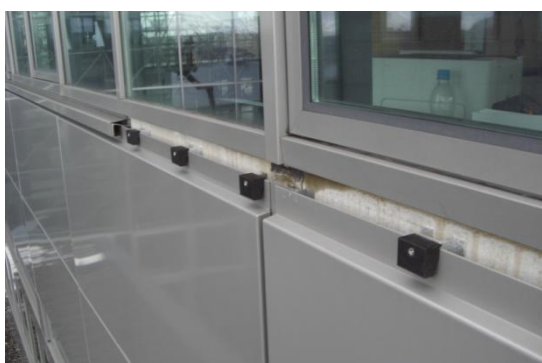
Mynd 9 Vatnsbretti hefur losnað og fallið af á austurhlíð.
