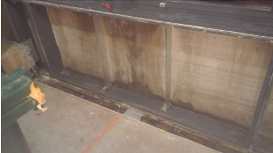
Vatnsleki inn í húsið
